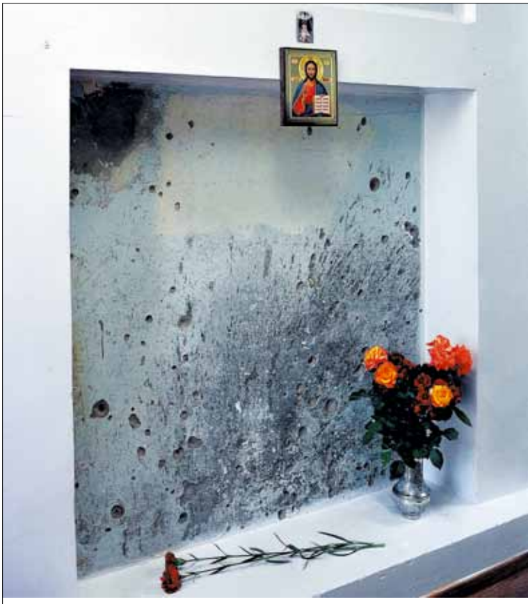
Стена в больнице Будённовска, пробитая пулями, возле которой басаевцы расстреливали беззащитных заложников. Фото Анны Ширяевой
